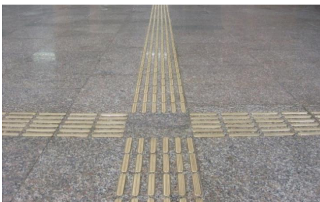
Umelé vodiace línie z kovových hmatových indikátorov osadených na dlažbe
